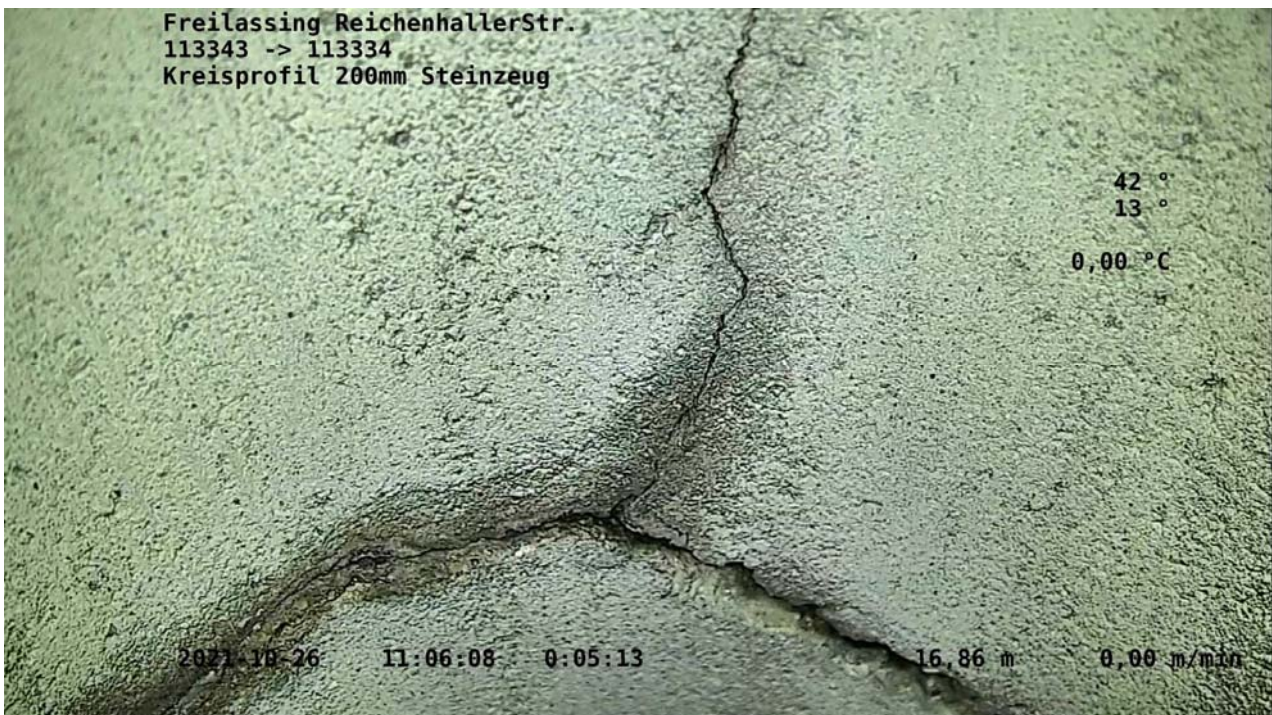
Detail – Rohrbruch – statische Überlastung
