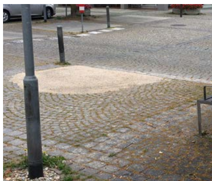
Hauptstraße | Fehlstelle im Bodenbelag
