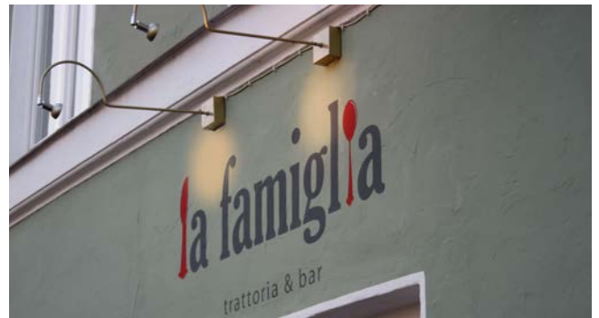
Anleuchten eines Schriftzuges mit Auslegerleuchten, sog. Werbeleuchten
