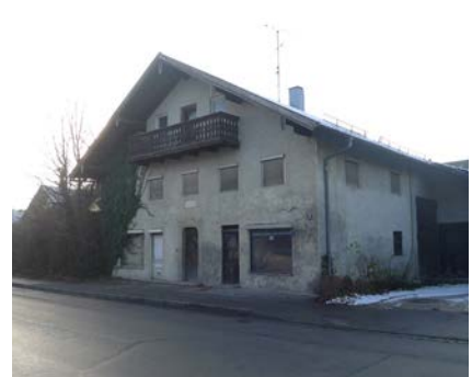
Leerstand und schlechter Gebäudezustand, Ludwig-Zeller-Straße
