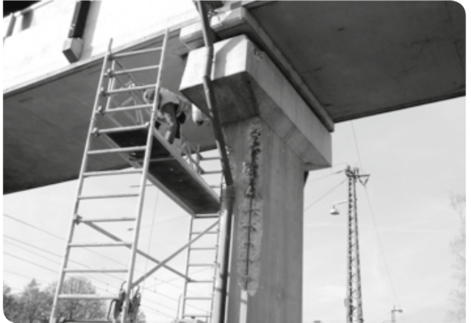
Der Zahn der Zeit nagt an jedem Bauwerk, so auch an den Betonpfeilern des Rupertusstegs, der die Rupertsstraße mit der Georg-Wrede-Straße verbindet. Die Sanierung wurde durch ein Spezialunternehmen durchgeführt. Die Koordination der Arbeiten gestaltete sich als sehr aufwendig, da bei einigen Pfeilern eine Abschaltung der Oberleitung über den Gleisen notwendig war. Dank der guten Zusammenarbeit mit der DB-AG konnten diese Arbeiten in den genau vorgegebenen Zeitfenstern erledigt werden.
