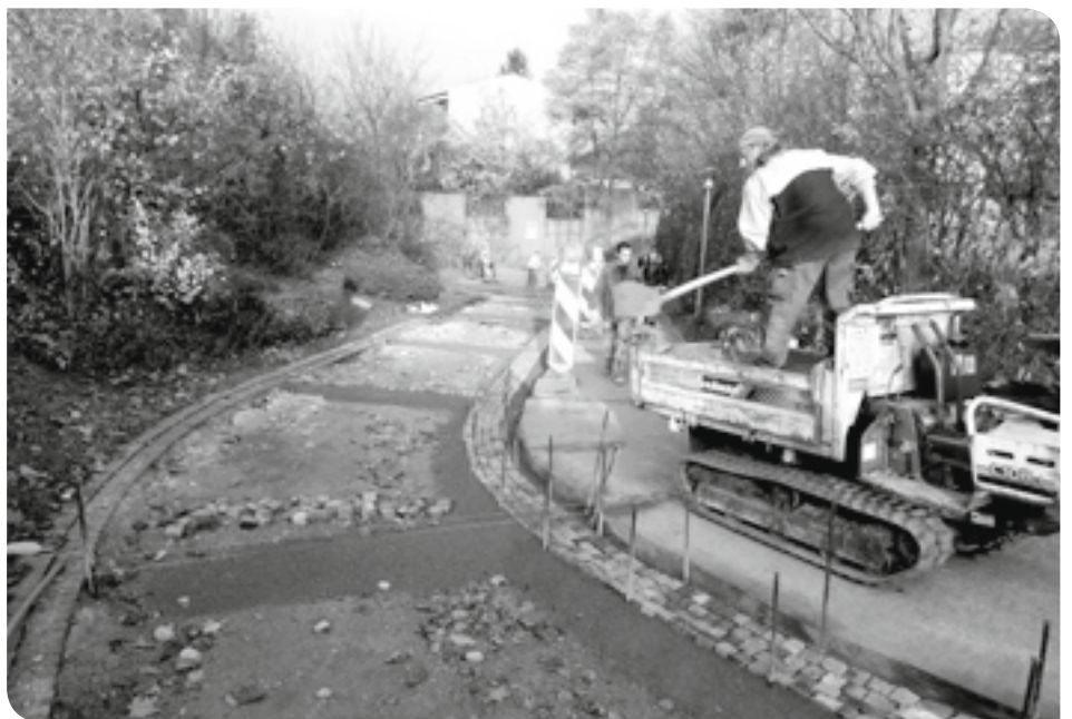
An der Abfahrtsrampe der Rad- und Fußwegunterführung zum Bahnhof haben die eingebauten Granitzeiler bis zu 4 cm Tiefe Absätze gebildet. Hierdurch war die Verkehrssicherheit für Radfahrer und Fußgänger nicht mehr uneingeschränkt gegeben. Die Sanierung wurde in zwei Etappen im Oktober und November 2010 durchgeführt.
