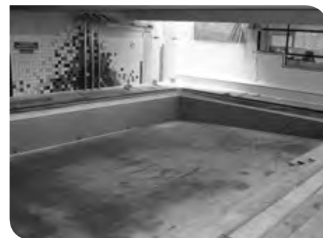
Auch das Nichtschwimmerbecken wurde bis auf den Rohbeton ausgehöhlt.
