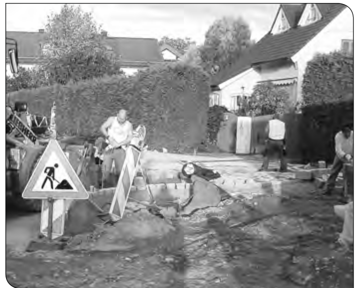
Die Granitpflasterfläche an der Untersberg- und Nocksteinstraße wurde im Oktober fertig gepflastert
