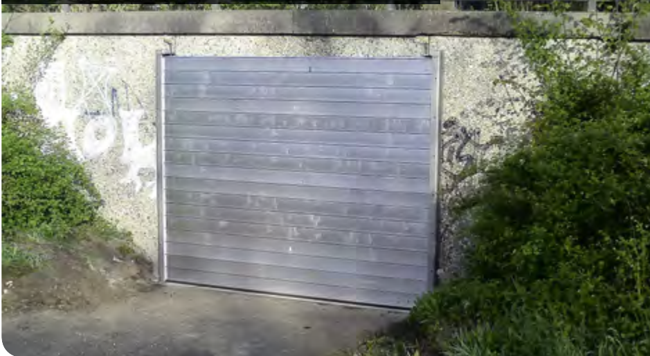
❸ An der Rad-/Fußwegunterführung an der Bundesstraße 20 zum Heideweg wurde für den Einsatzfall eine mobile Dammbalkenkonstruktion installiert.
